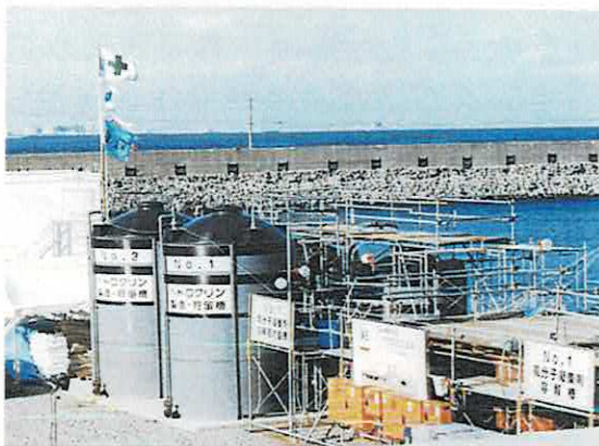
四日市港川越泊地浚渫工事で導入されたヘドロクリン供給プラント
